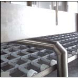
De openingen van de turboblower zijn zowel onder als aan de zijkant van de transportband geplaatst.
