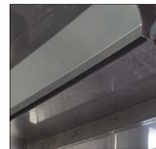
De bovenste uitblaasopeningen van de droogtunnel staan onder een hoek om het verwijderen van water van elk soort oppervlakte te optimaliseren.
